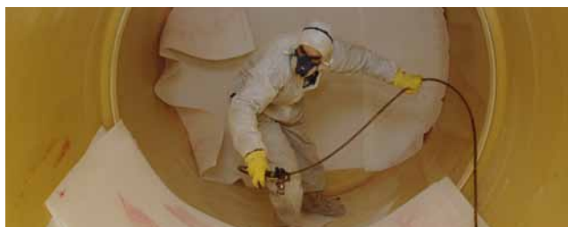
3. Pose de la mousse perméable à l'air entre la citerne existante et l'enveloppe intérieure
